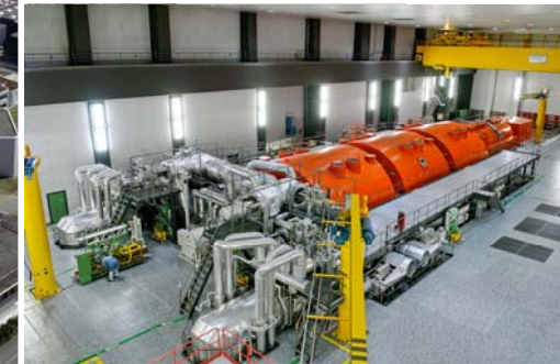
③ Salle des machines
